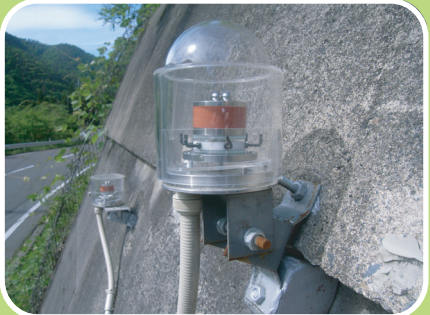
打ち継ぎ目を境界に、上部が水平にズレている擁壁に設置
